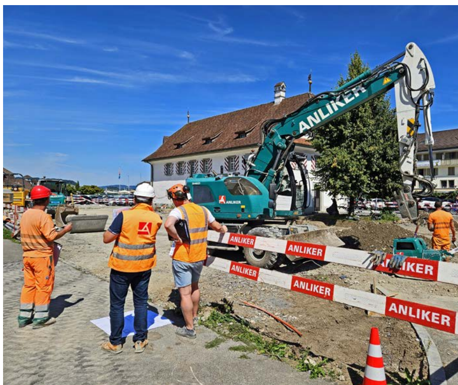
Ende August liefen die Arbeiten an der Neugestaltung des Dorfkerns auf Hochtouren. Kommandes Jahr wird sich die Sust dann wieder einladender präsentieren. Bild rgi
