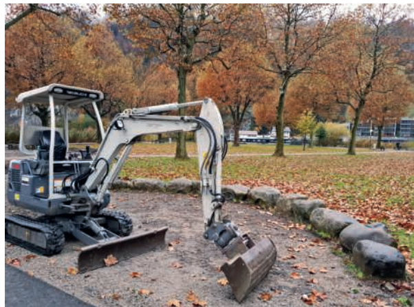
Mit verschiedenen dezenten baulichen Eingriffen wurde das Areal der Garnhänki in den vergangenen Monaten aufgewertet. Bild zvg
